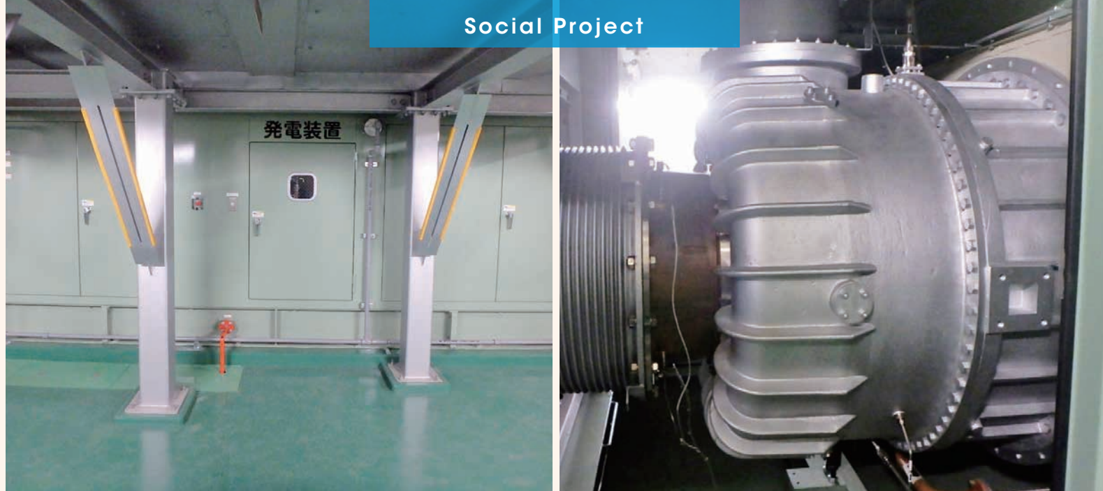
湯島ポンプ所 (非常用発電設備)
